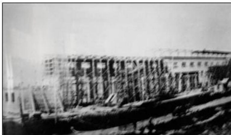
Строительство кузнечного цеха на заводе № 77 («Трансмаш»). Фото 1943 г. из фондов музея школы № 49
